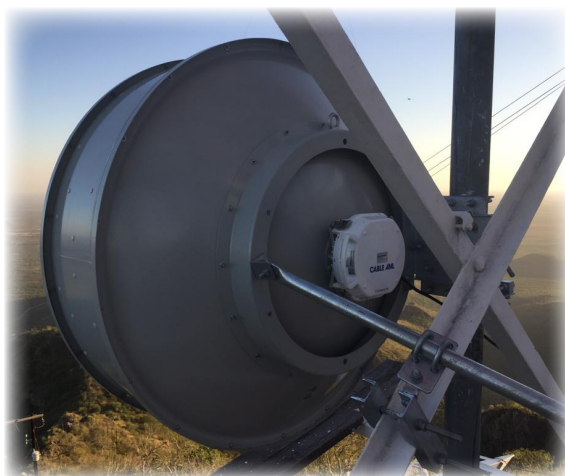
Antena receptora montada en torre
