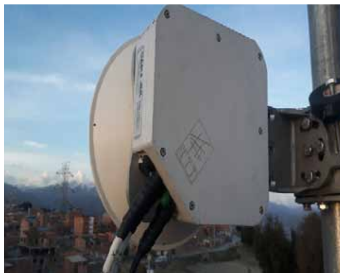
Instalación de CPE (terminal cliente)
