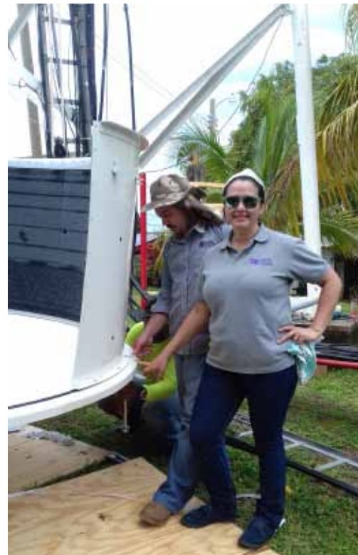
La Gerente de Operaciones de Zona Norte de Cable Color, Ing. Wendy Romaña, instalando el IP Link.
