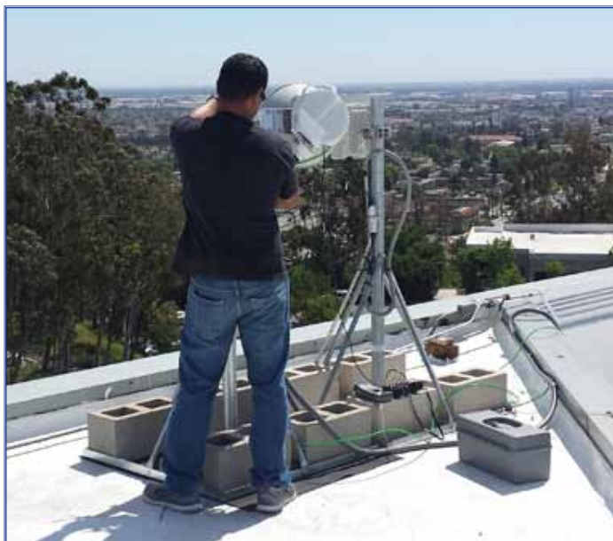
Alineación e Instalación del Enlace IP.
