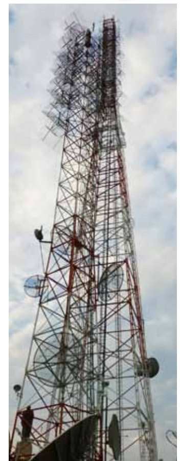
Vista de la torre de transmisión de Univisa mostrando las antenas de TV y de Internet inalámbrico.
