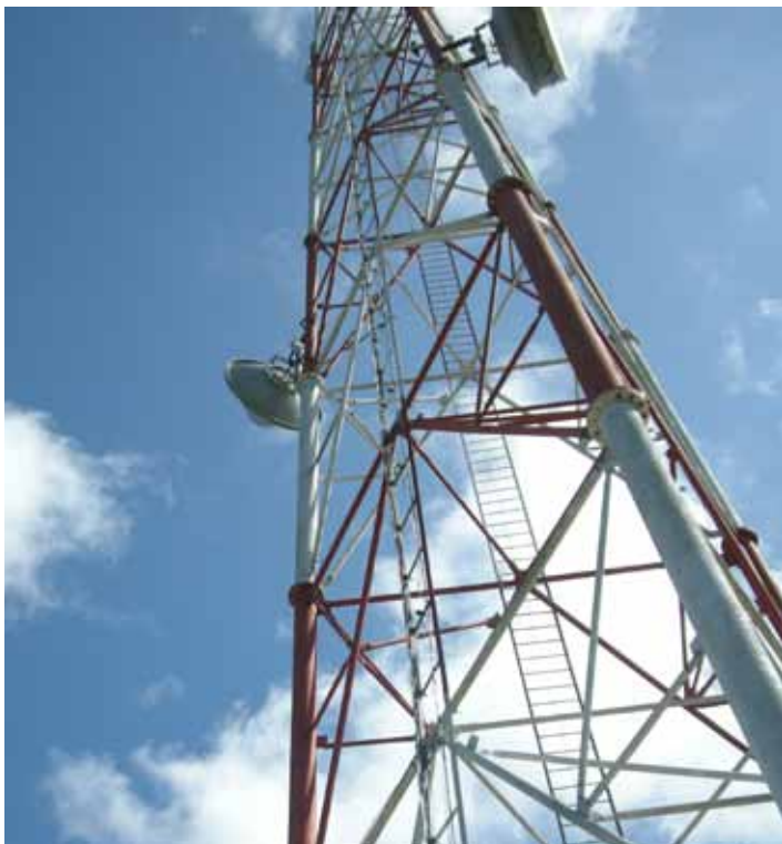
Las antenas de diversidad de ruta con radomos cónicos de los enlaces IP de alta capacidad.
