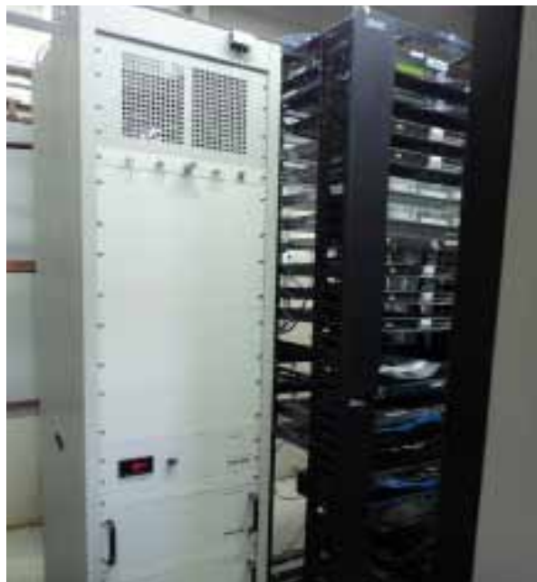
Transmisor de banda ancha de 1000 Vatios utilizado por Megacable para la transmisión de 256 QAM.
