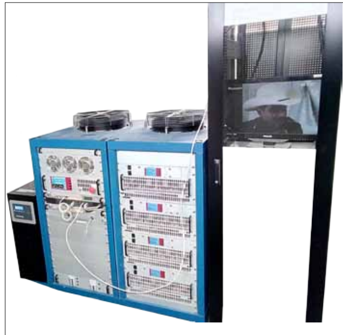
Transmisor Digital de 1,7 kW RMS y unidad receptora del STL instalados en Cerro la Virgen, Zactecas (México)
